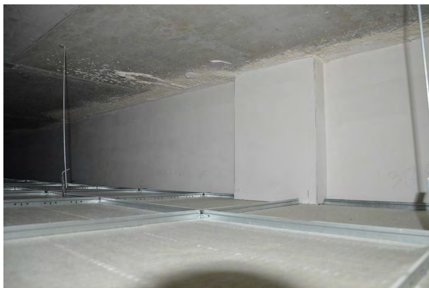
Rys. 20. Widok dolnej krawędzi płyty stropodachu.
