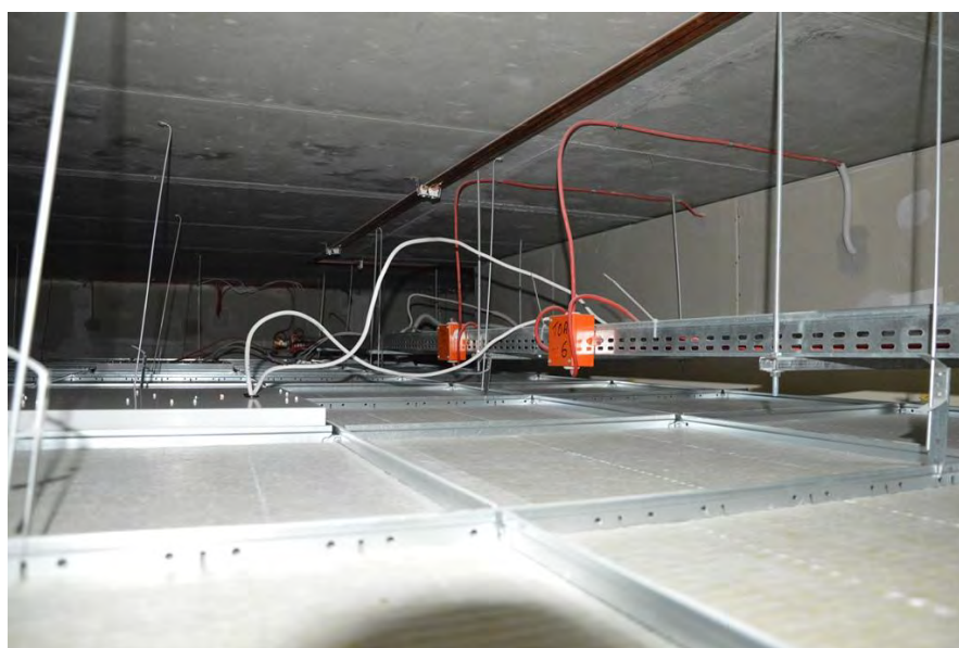
Rys. 21. Widok dolnej krawędzi płyty stropodachu.
